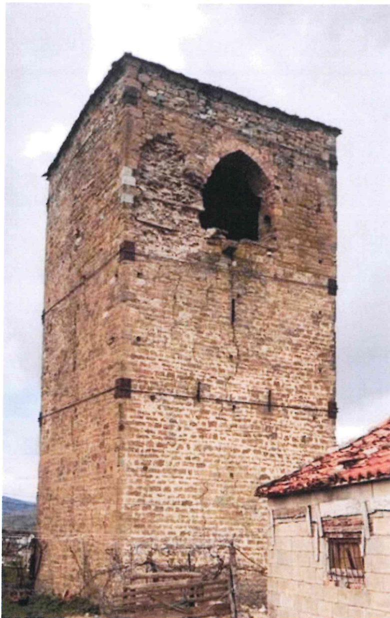
Renie e muratures dhe deformim i muratures , FOTO 2019
