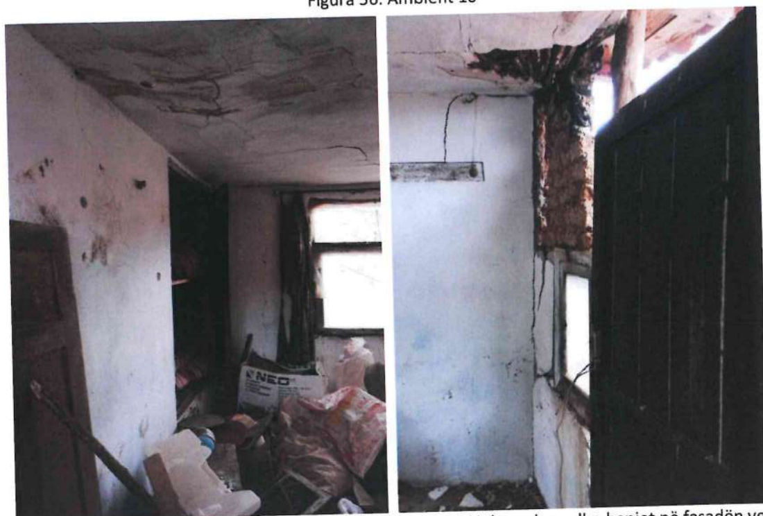
Figura 57. Ambient 10, majtas- dollapi i murit, djathtas- muri i degraduar dhe hapjet në fasadën veriore
