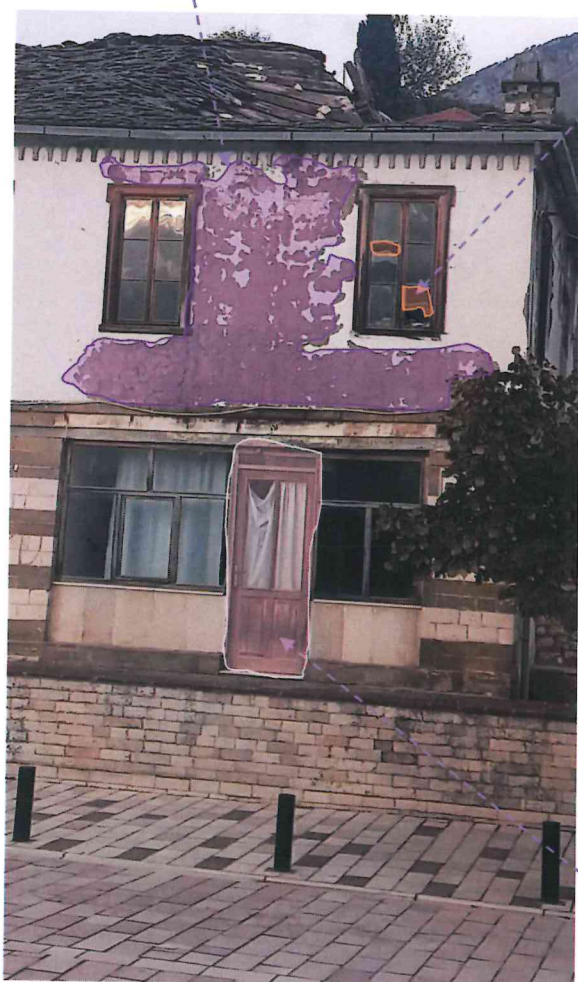
Foto 8: Gjendja e fasades
