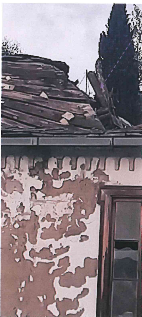
Foto 6: Renie e materialeve te catise duke shkaktuar hapje ne cati
