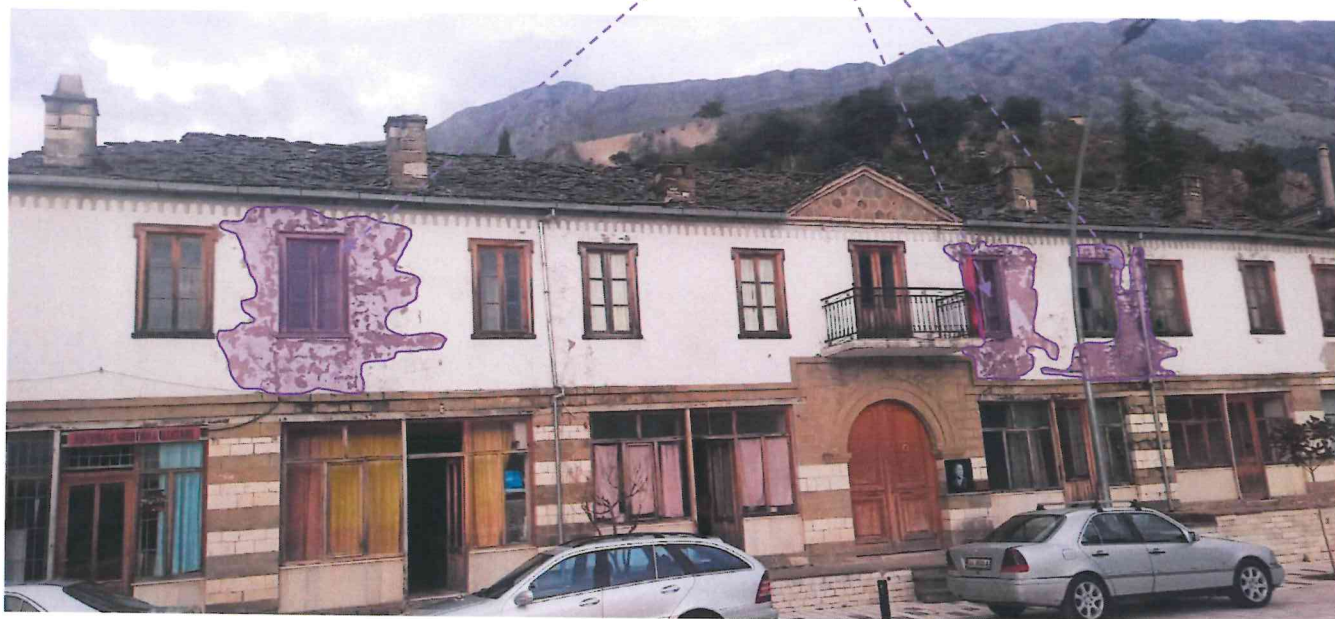
Foto 7: Gjendja e fasades
