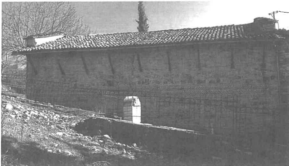
Foto 13. Pamje e fasadës veriore ku vërehen qartë çarjet vertikale në muraturë
