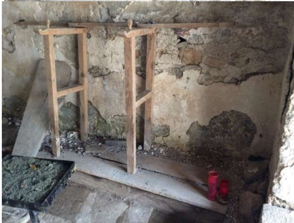
Shenja të lagështisë në muret e brendshëm perimetralë
