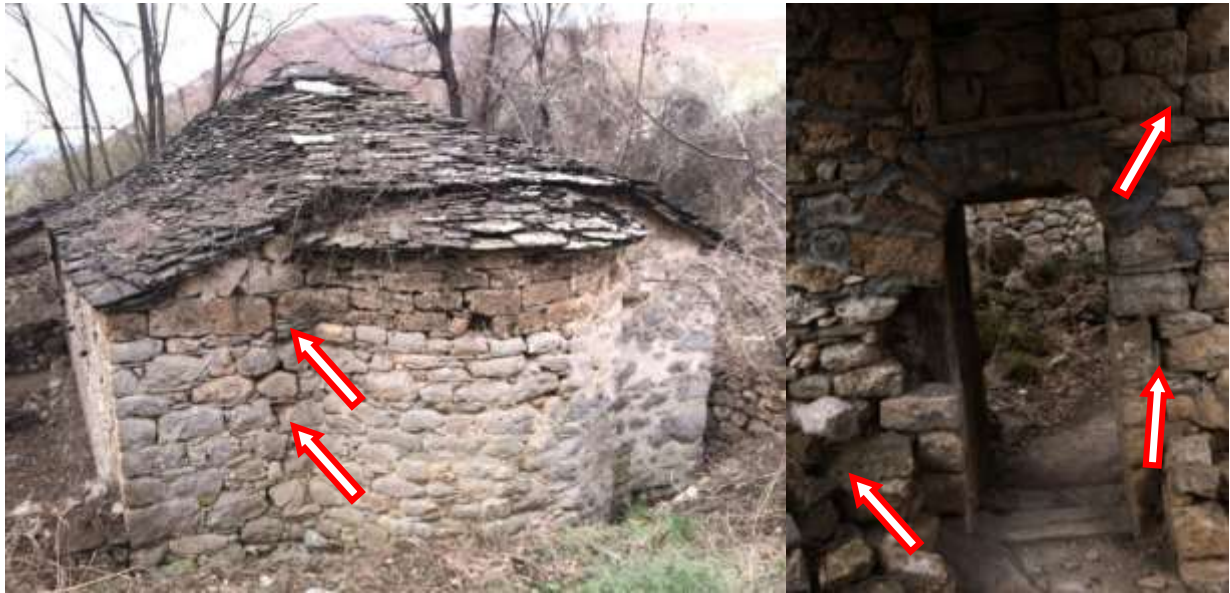
Degradimi i llaçit gëlqeror të fugave
