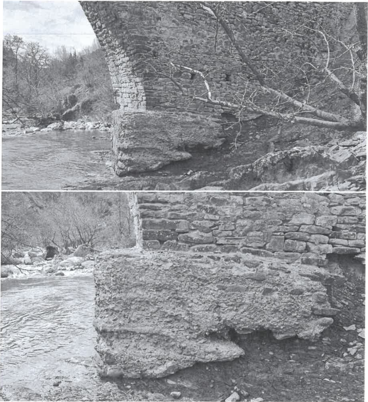
Fig.20- Jastiku i betonit, bjefi i sipërm
