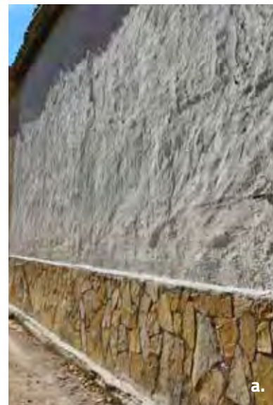
a. Një mur i suvatur me një shtresë të trashë suvaje në Dhërm. Nuk këshillohet veshja e bazamentit me pllaka guri për mbrojtje nga lagështia.
