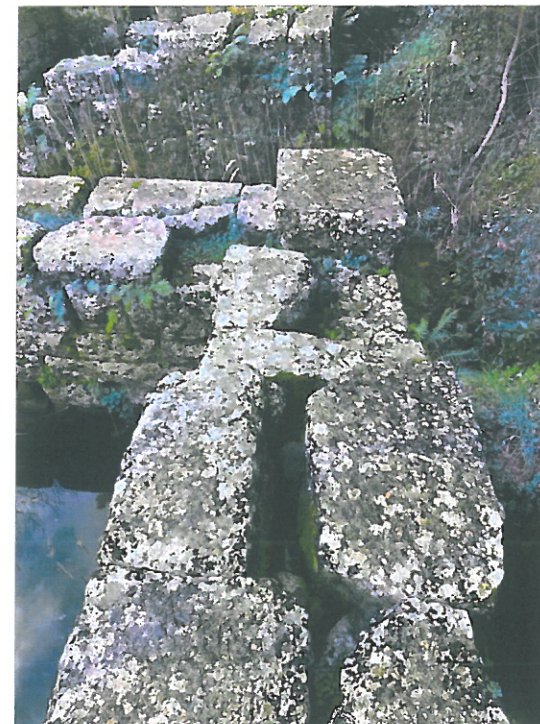
3. Foto ku evidentohet destabilizim i gurëve mbi arkitraun e betonit (mbi portën 1) dhe largim të gurëve nga njëri tjetri.
